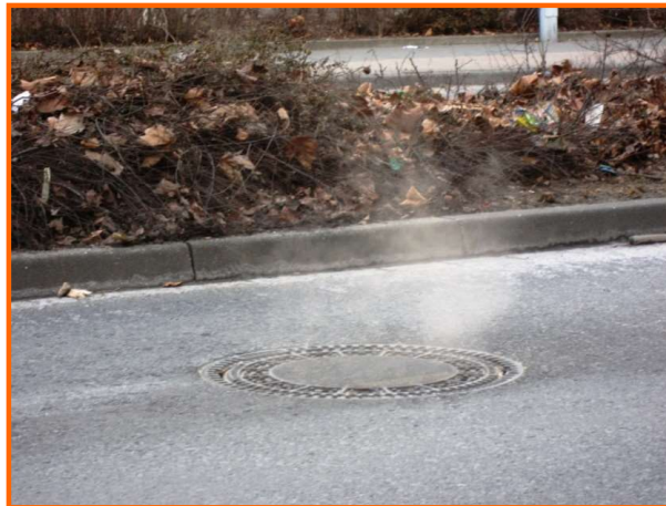
Bild vom 01.02.2009 (Jülicher Straße, Aachen)
