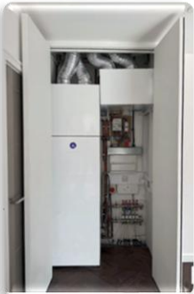
Quelle: Quantum Energietechnik GmbH
