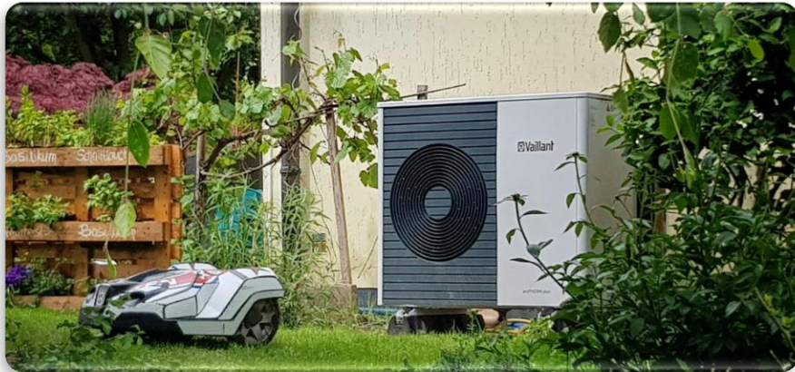
Beispiele: Einfamilienhaus mit Luft/Wasser-Wärmepumpe
